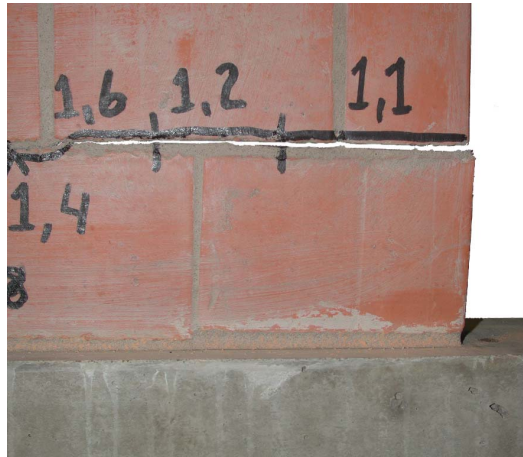
Figura 4.36 Detalhe da fissura no canto da porta – Modelo 3, Situação 2.
