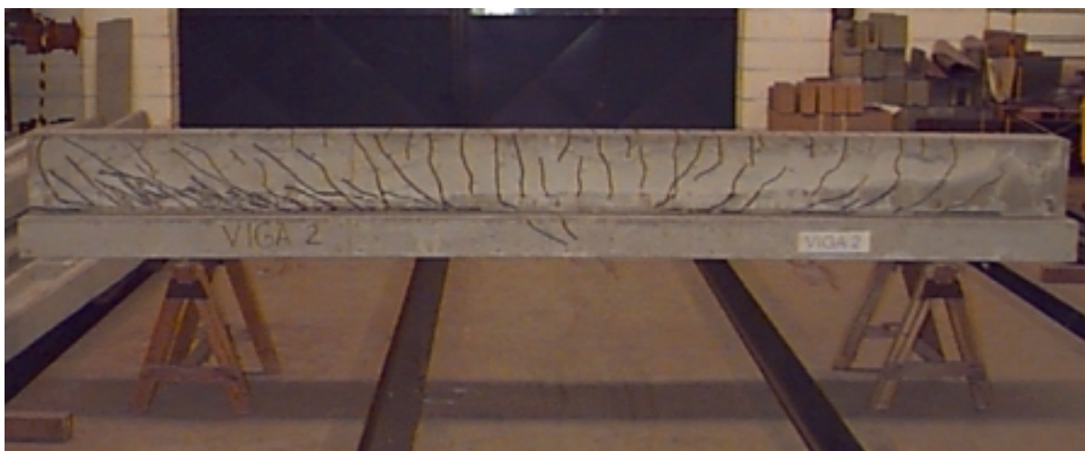
Figura 6.20 – Panorama de fissuração de uma viga composta com laje moldada no local (ARAUJO (1997)).
