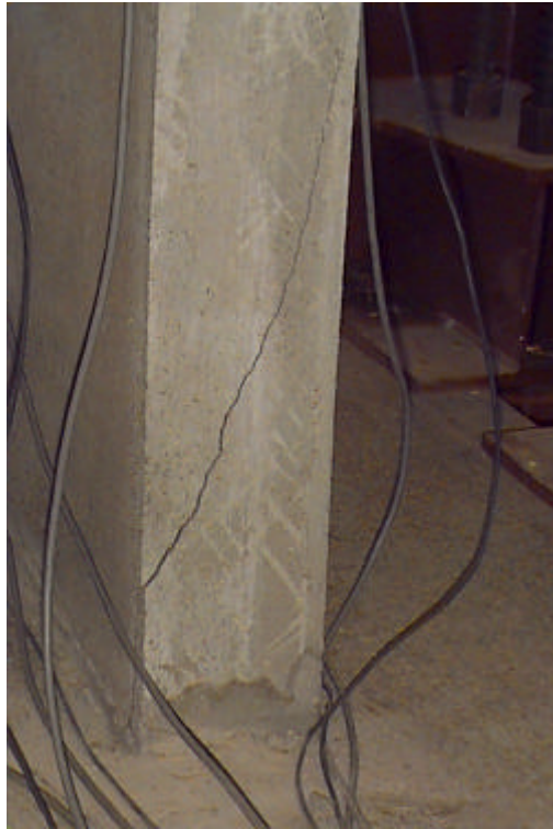
FIGURA D11 – RUPTURA DO PSC-IIA NA NERVURA NA PARTE INFERIOR DO PAINEL
