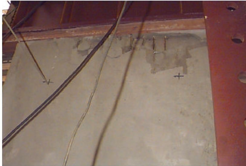
FIGURA D13 – RUPTURA POR ESMAGAMENTO NA PARTE SUPERIOR DO PSC-IIIa
