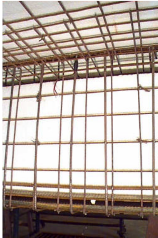
FIGURA 6.11 – DETALHE DA CONEXÃO ENTRE A TELA DA ALMA E A TELA DA MESA. DISTRIBUIÇÃO DA ARMADURA DE TRAÇÃO
