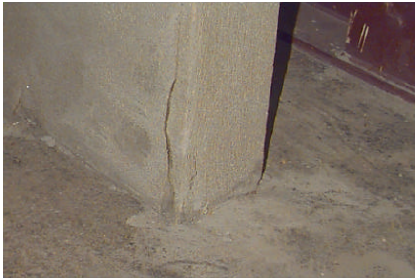
FIGURA D12 – RUPTURA DO PSC-III NA NERVURA NA PARTE INFERIOR DO PAINEL
