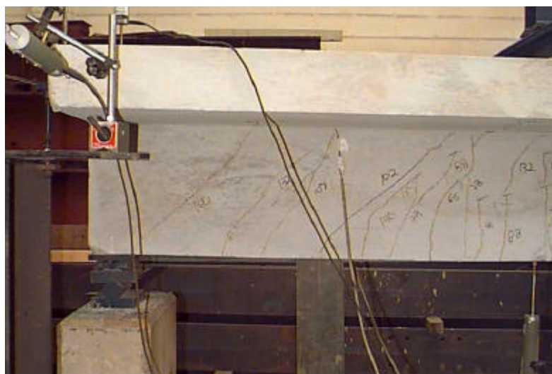
FIGURA C13 – CONFIGURAÇÃO DAS FISSURAS PRÓXIMO AO APOIO
