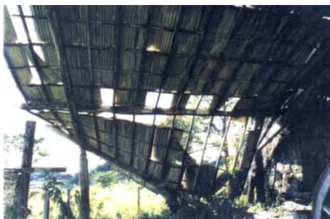
Figura 3.5 – Detalhe da cobertura danificada fonte: Arquivo Público Municipal
