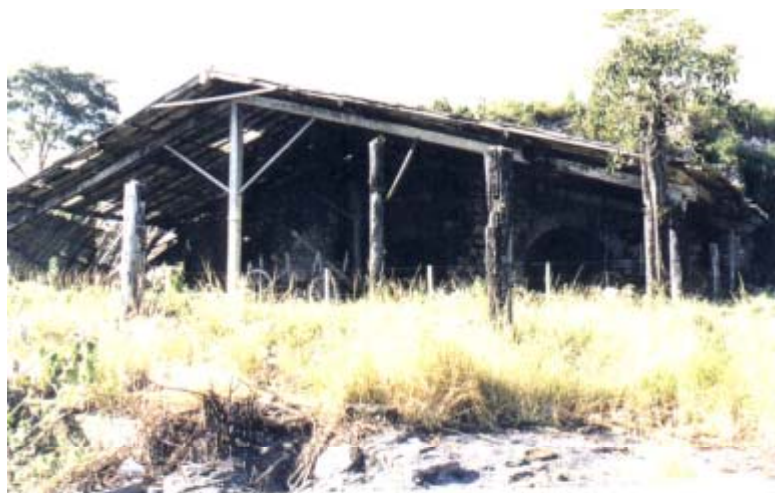
Figura 3.6 – Visão geral da cobertura danificada fonte: Arquivo Público Municipal, 1999
