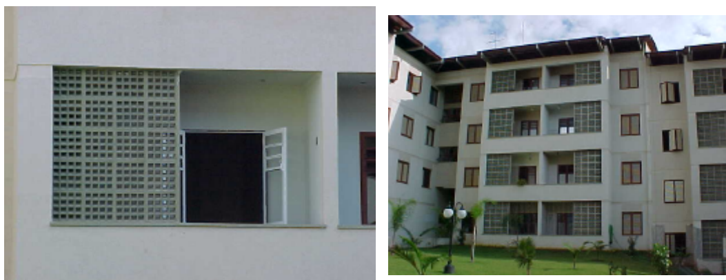
Figura 5.43: Foto da fachada de um edifício em alvenaria estrutural com aplicação de elementos vazados modulares de concreto
