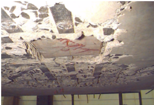
Figura 4.149 - Detalhe da superfície de ruptura formada após o carregamento pós-ruptura
