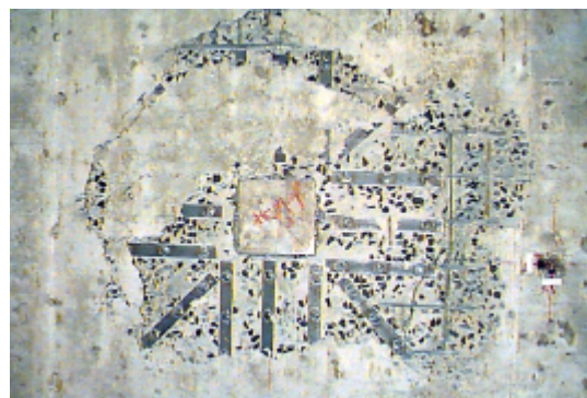
Figuras 4.144 – Detalhe da ruptura na face inferior do modelo (superfície de ruptura além da região transversalmente armada)
