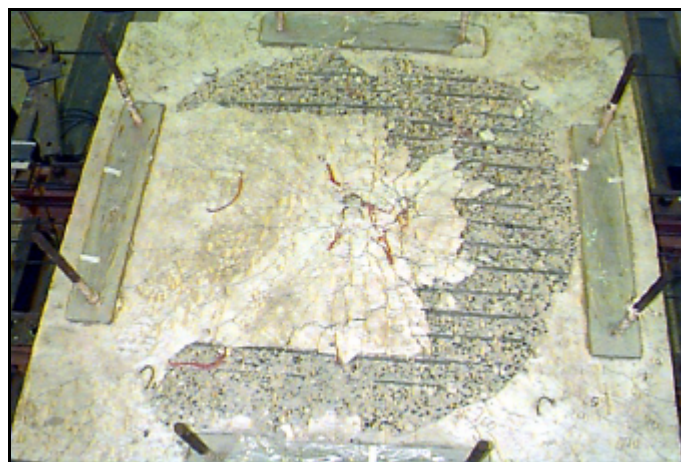
Figuras 4.142 - Vista da face superior, após a retirada do material completamente solto
