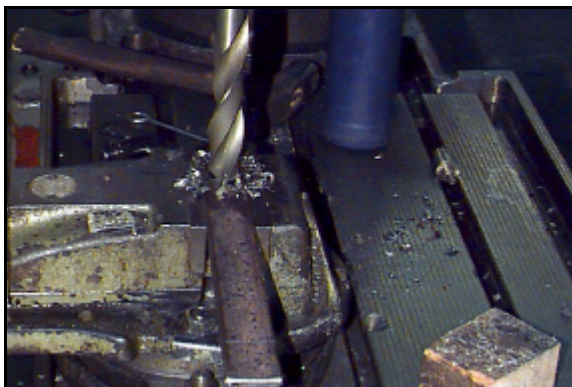
Figura F.3 - "Escareamento" dos furos, visando facilitar a aplicação da solda elétrica
