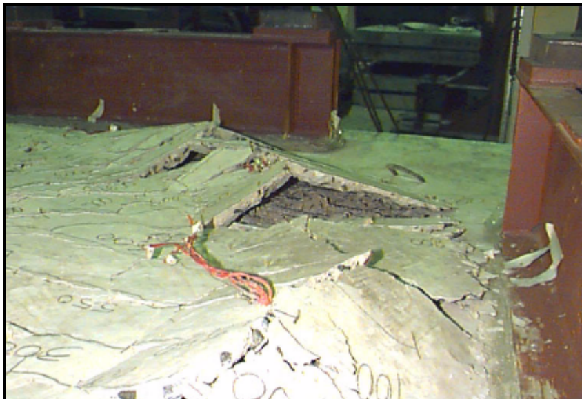
Figura 4.137 - Destacamento do cobrimento durante o carregamento pós-ruptura
