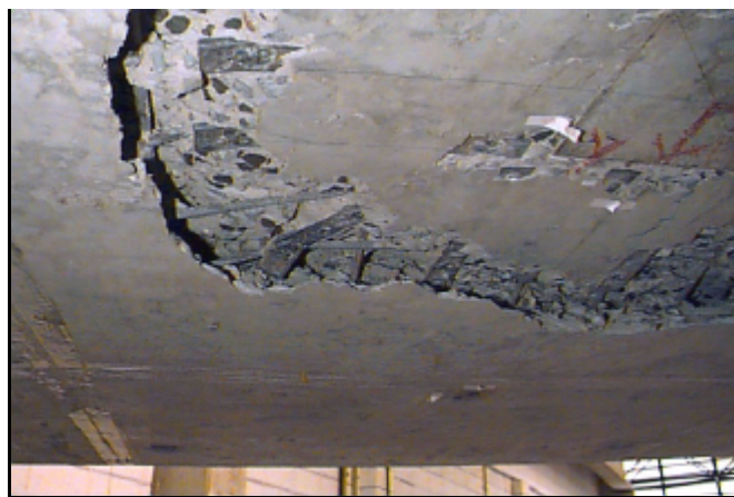
Figura 4.131 - Detalhe da ruptura na face inferior
