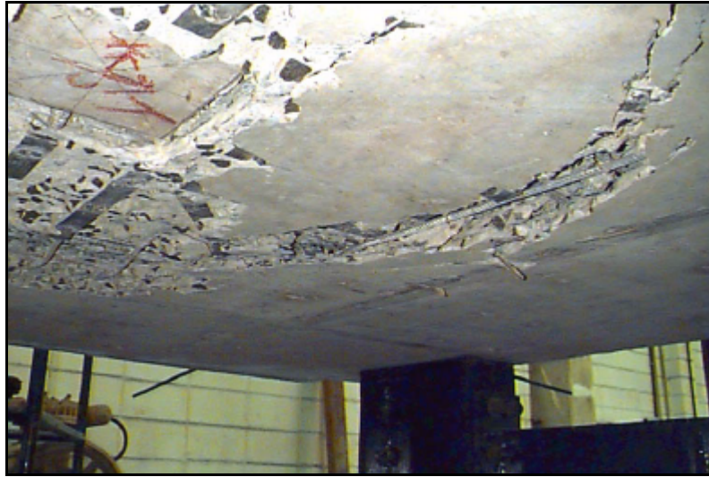
Figuras 4.148 - Vista das superfícies de ruptura, anterior e após o carregamento pós-ruptura
