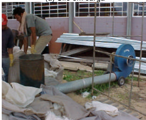
(c) Detalhe do carregamento do depósito e da ventoinha do carregador pneumático
