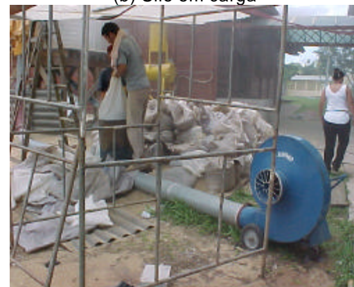
(d) Detalhe do carregamento do depósito e da ventoinha do carregador pneumático
