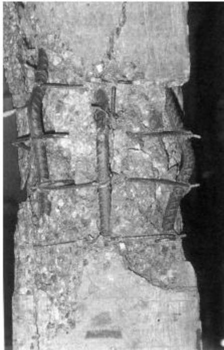
Figura 3.10. Flambagem das barras da armadura longitudinal, RANGAN e LLOYD (1994)
