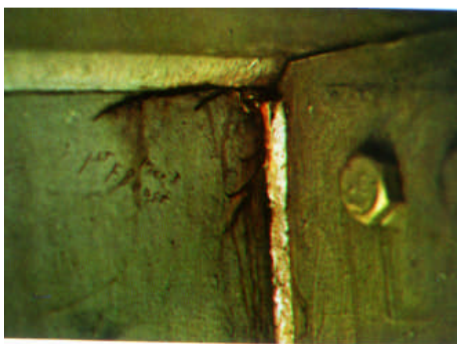
FIGURA 3.10 - Fissura observada na conexão entre longarina e transversina. FISHER (1981)
