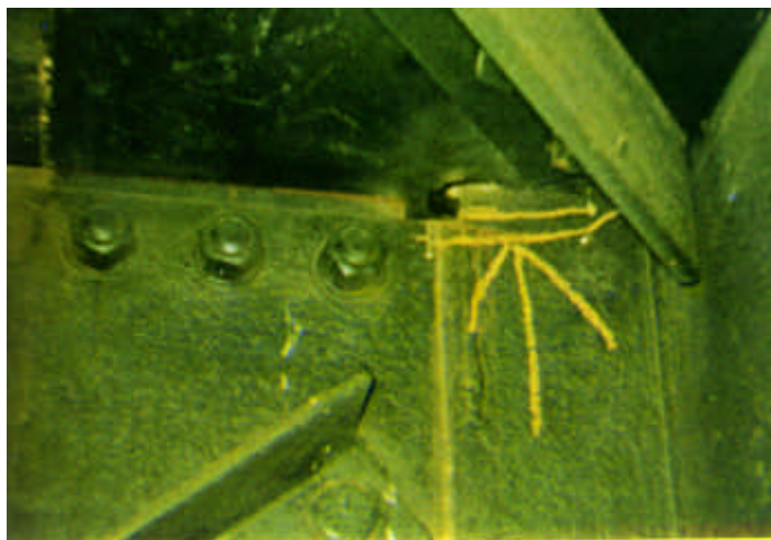
FIGURA 3.13 - Fissura no sistema de ligação de contraventamentos horizontais. FISHER (1981).
