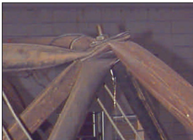
Figura 4.31 – Rotação excessiva e plastificação da região nodal
