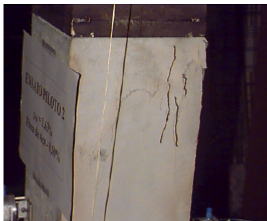
FIGURA 4.10 - Primeiras Fissuras - Piloto 2
