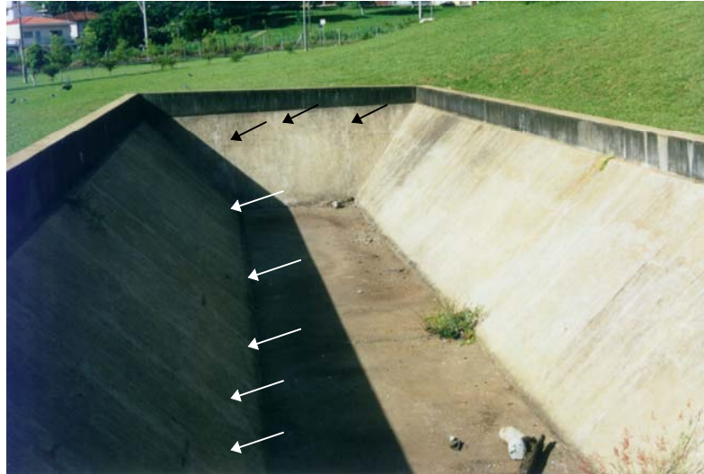
Fig. 6.2: Aspecto do reservatório da EESC (notar fissuras nas juntas de argamassagem)
