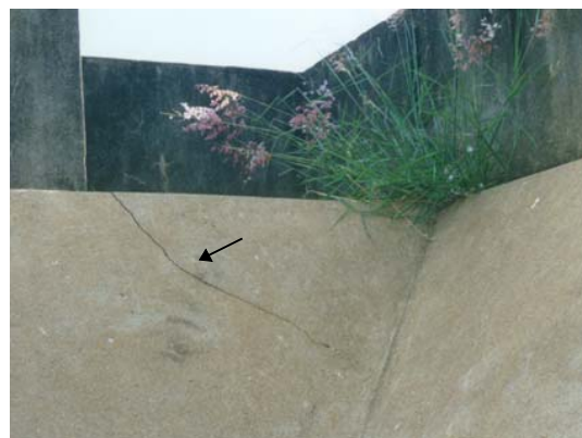
Fig. 6.3 : Fissura na região de interferência com poço de visita
