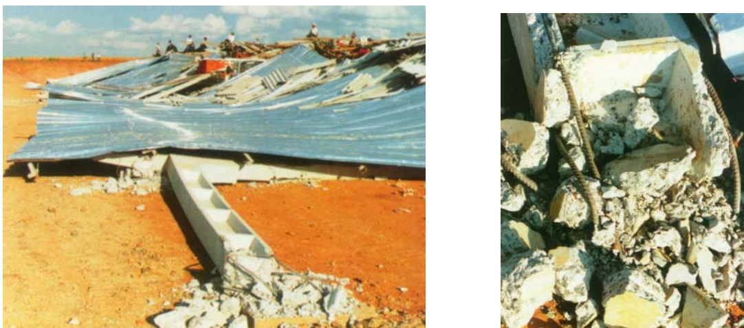
Figura 6.2 - Desabamento de um galpão pré-moldado.
