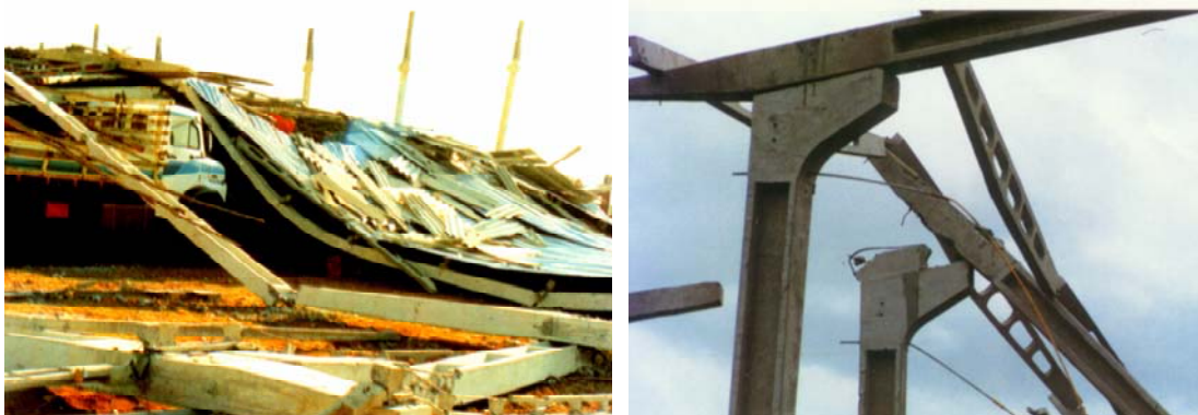
Figura 1.2 - Exemplos de desabamentos de galpões pré-moldados.
