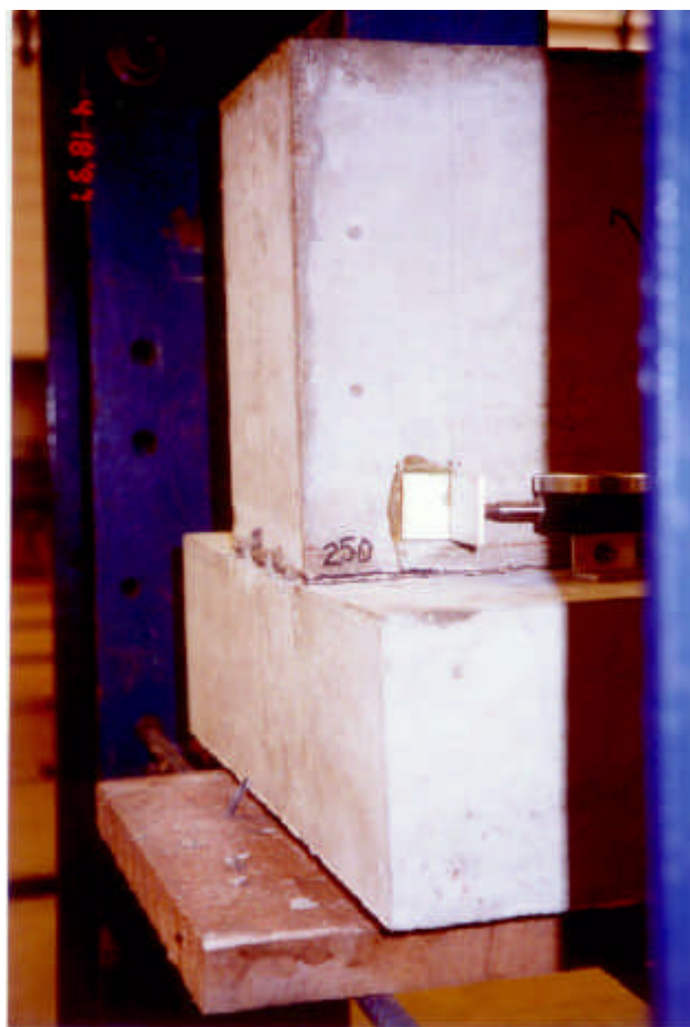
Figura 5.12(f) - Separação entre a mesa e a alma na extremidade da viga 3.
