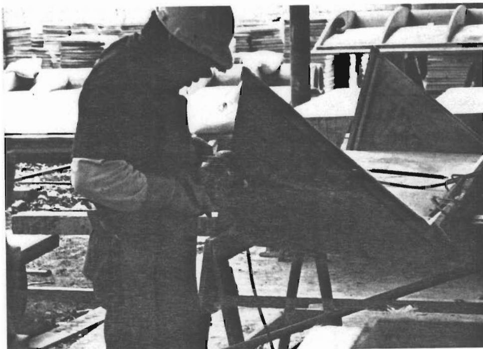
Foto 4.17 – Tratamento de ponto de exposição de armadura.
