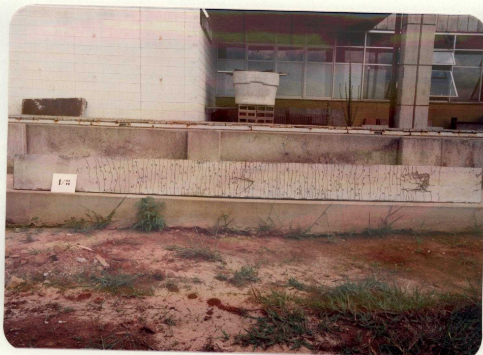
FOTOGRAFIA 28 - CONFIGURAÇÃO DE RUÍNA DA MESA TRACIONADA DO MODELO 1/3
