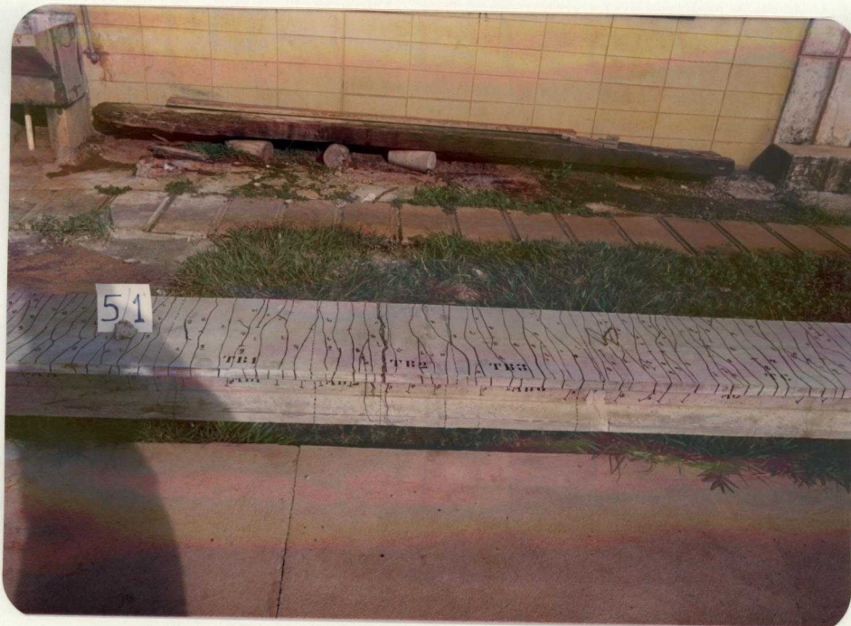
FOTOGRAFIA 44 - CONFIGURAÇÃO DE FISSURAÇÃO DA MESA TRACIONADA DO MODELO 5/1
