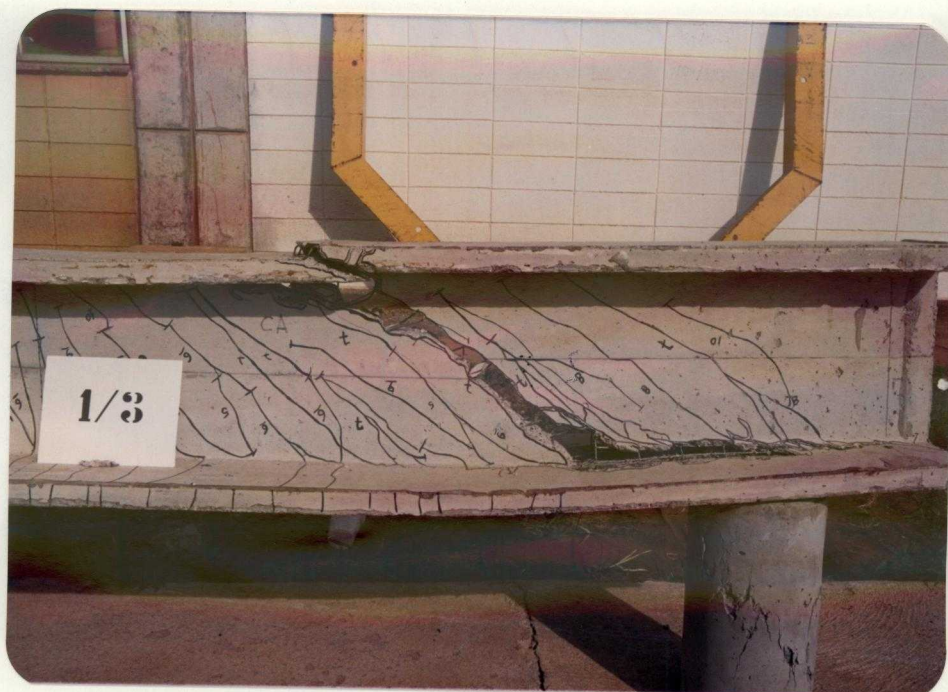
FOTOGRAFIA 26 - DETALHE DA RUPTURA POR FORÇA CORTANTE DO MODELO 1/3
