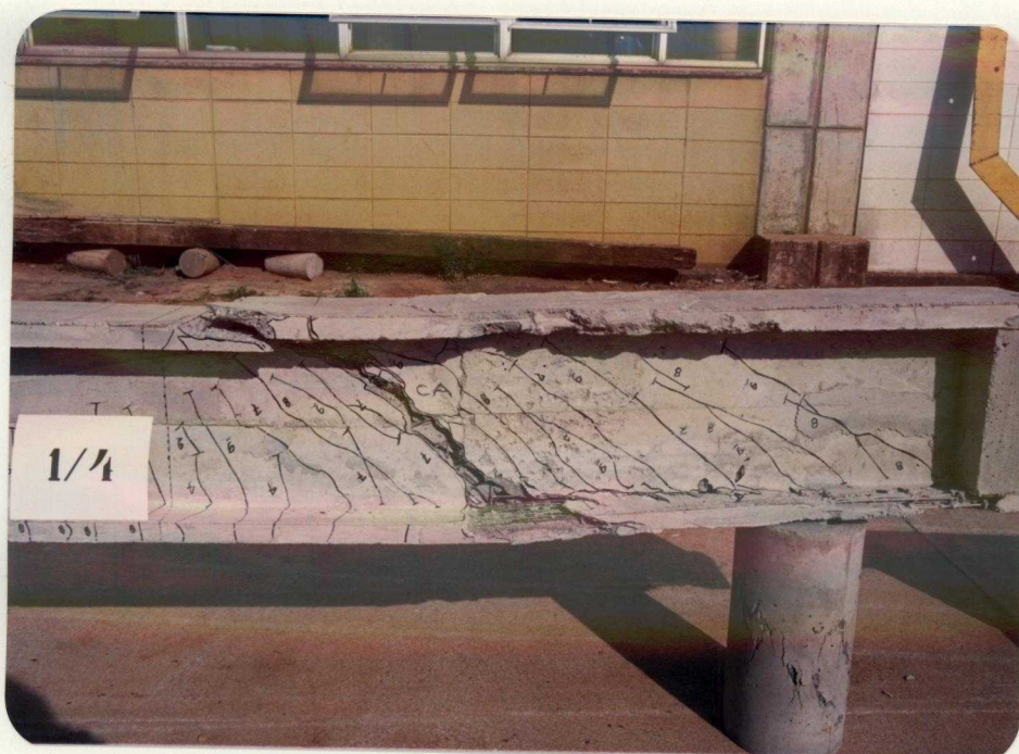
FOTOGRAFIA 30 - DETALHE DA RUPTURA POR FORÇA CORTANTE DO MODELO 1/4
