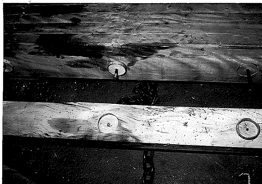
Fig. 77 -Ruptura por cisalhamento na ligação pelos anéis
