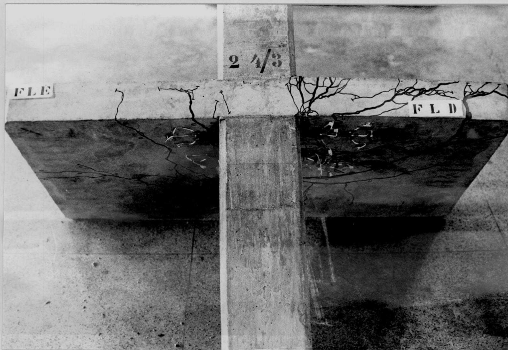
Fig. 3.1.10.b - Fissuração na face lateral do modelo EdL 24/3.
