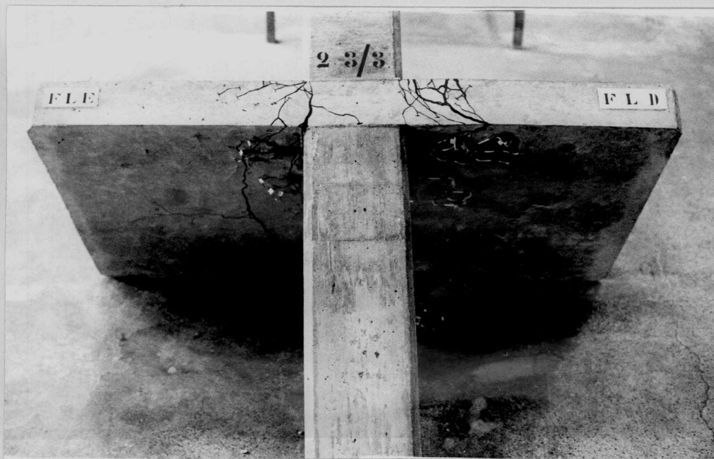
Fig. 3.1.7.b - Fissuração na face lateral do modelo EdL 23/3.
