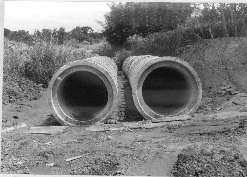
Foto 2.4 - Construção de galeria com tubos de concreto - após a colocação dos elementos.
