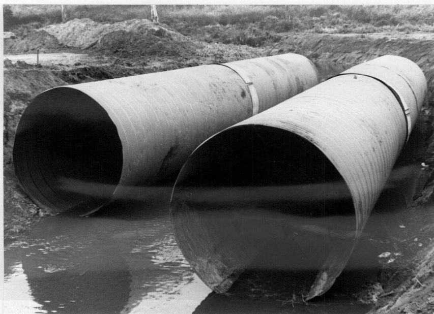
Foto 2.5 - Galeria em linha dupla de tubos com diâmetro de 2,80m sem emenda na seção transversal.
