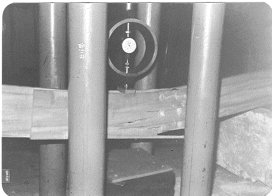
FIG. 52 — Ruptura de uma viga com emenda cavilhada
