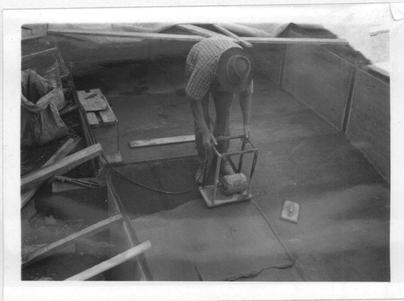
Fig. 3.4.21 - Final da moldagem. Ao fundo pode-se ver a co bertura de proteção com capa plástica.
