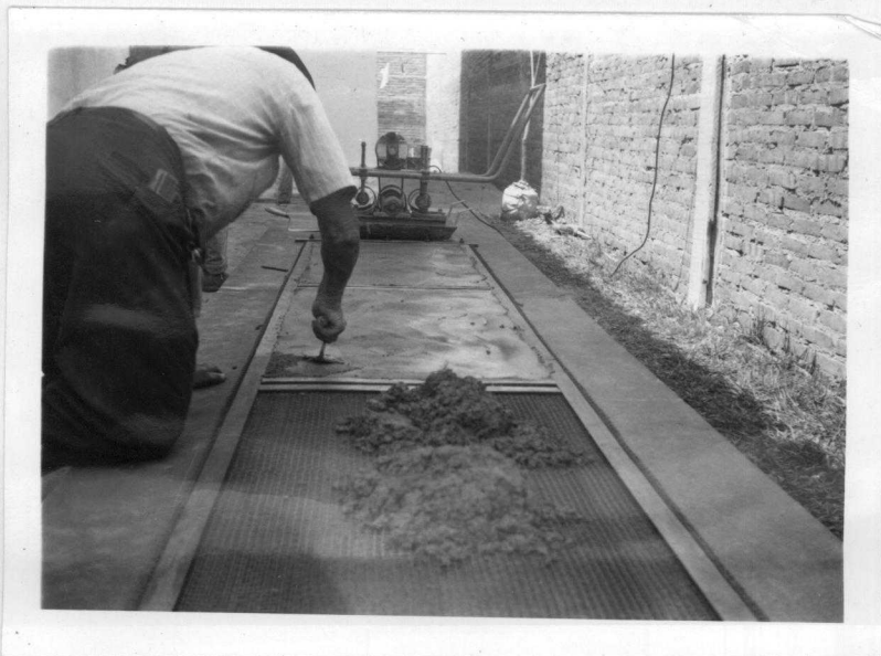
Fig. 3.4.5 - Fase inicial da confecção. A argamassa está sendo forçada contra as telas com a colher.
