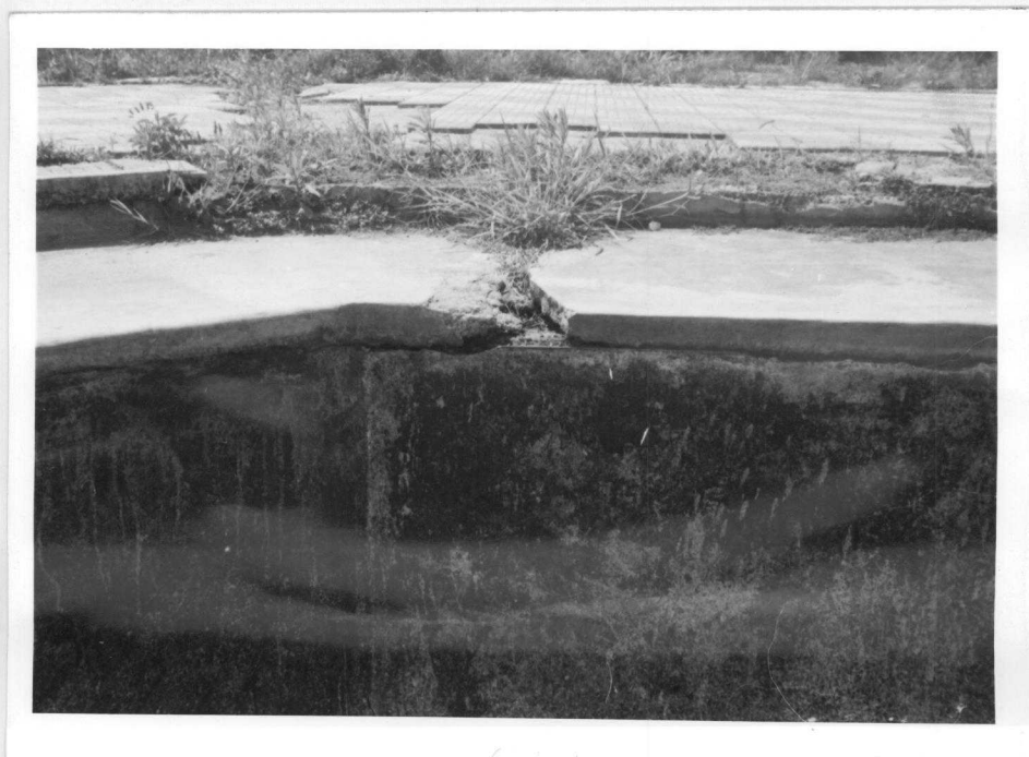
Fig. 3.2.14 - Destruição da argamassa e corrosão das telas na "prainha".
