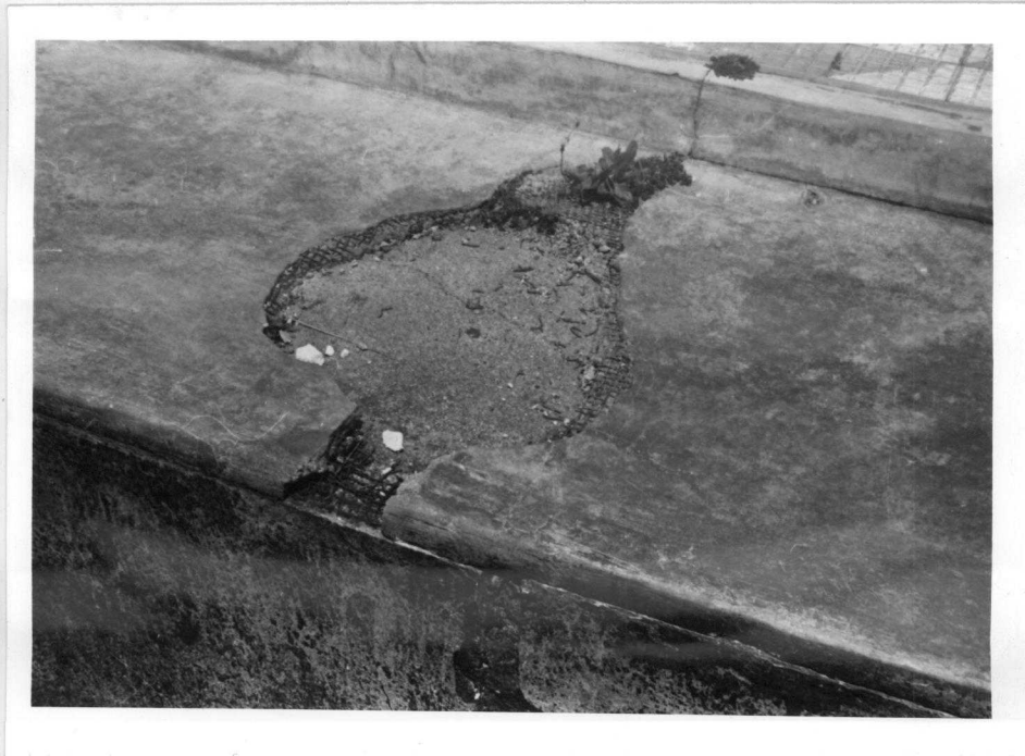
Fig. 3.2.16 - Perda do recobrimento e destruição das telas da "prainha".
