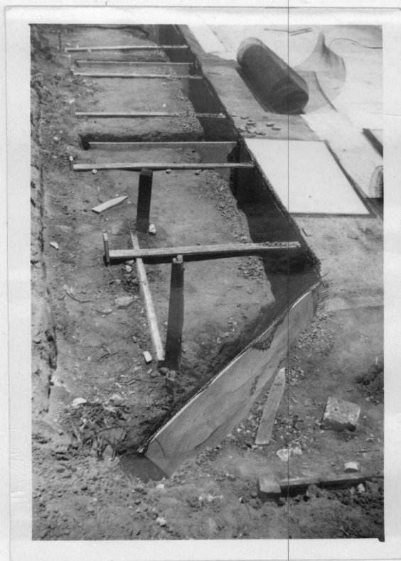
Fig. 3.1.4 - Montagem das placas "prainha" e "gigante" na parte escavada. Note-se o enchimento da escavação com brita nº 1 para garantir o atrito com a placa "gigante".
