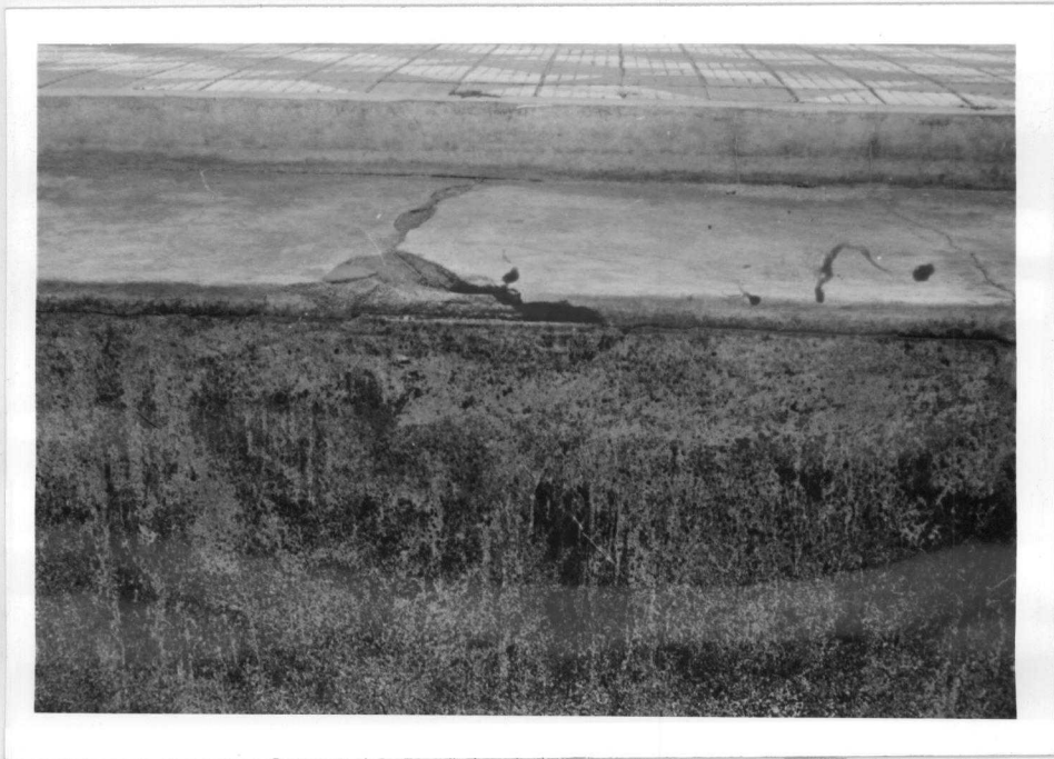
Fig. 3.2.6 - Espessura do recobrimento da armadura da "prainha". Não se notam as telas da junta "parede-prainha".
