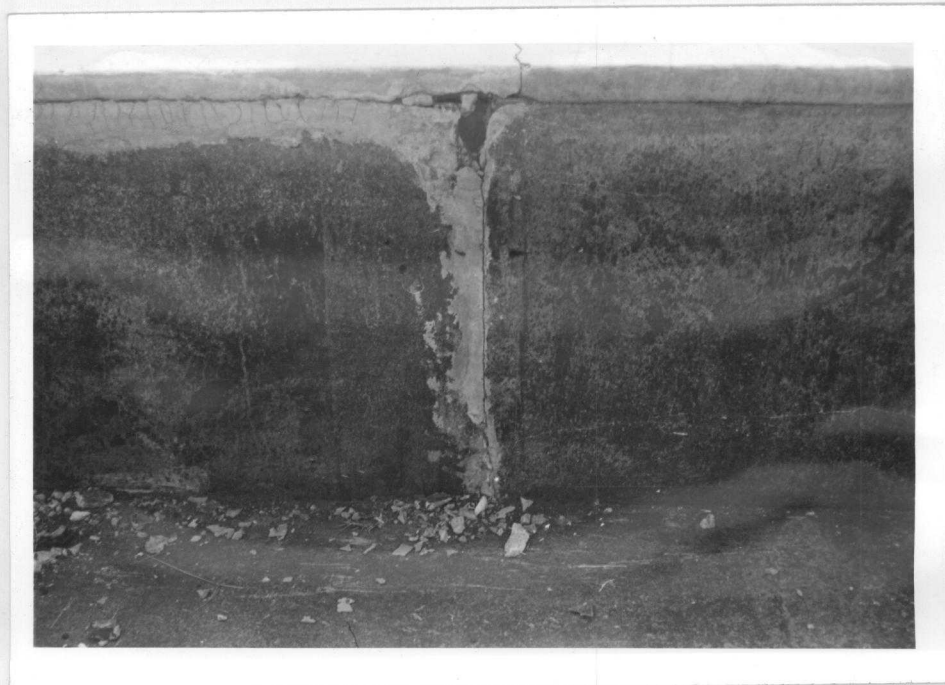
Fig. 3.2.10 - Outra junta destruída. Há um vazio cavernoso atrás das placas. Notem-se as fissuras de retração na argamassa muito rica, empregada em mais uma tentativa, sem sucesso, de vedar a trinca.
