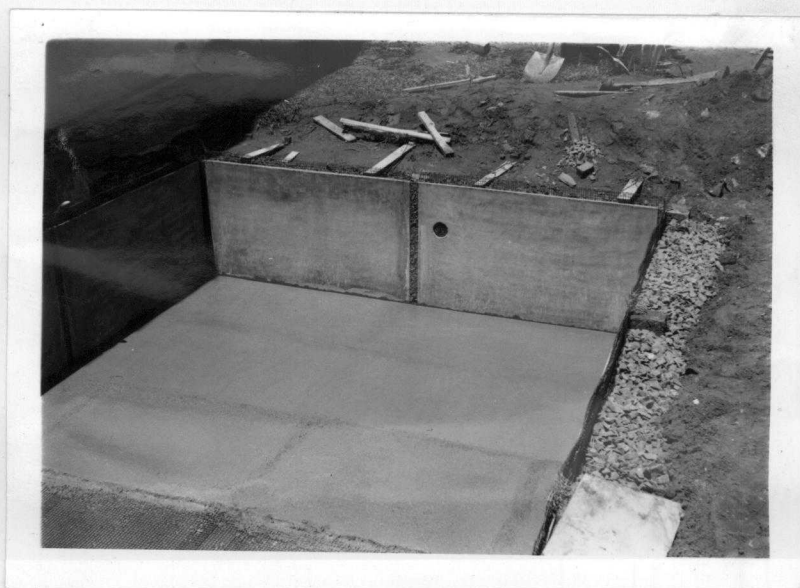
Fig. 3.4.19 - Execução da argamassa do fundo. Note-se o "enchimento" com brita nº 2 entre o terreno e as paredes, envolvendo o pilarete.
