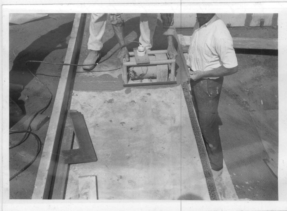
Fig. 3.1.8 - Execução das juntas "prainha-gigante" e "prai- nha-parede". Note-se a argamassa sendo força- da através das telas com vibrador de placa.
