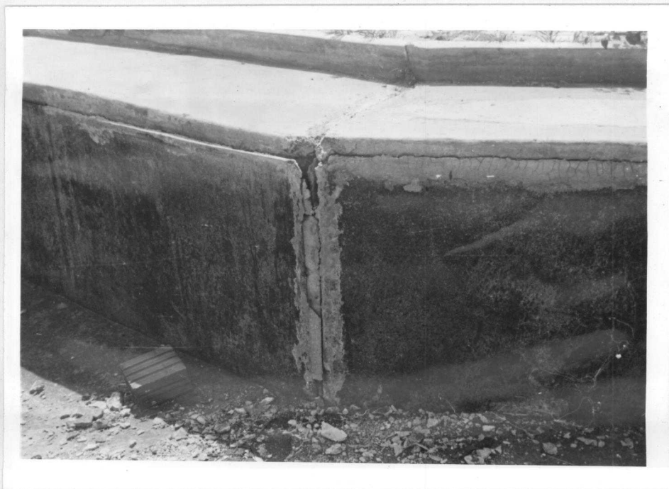
Fig. 3.2.9 - Destruição das juntas. A corrosão provocou o desligamento das peças. Note-se a tentativa de se reparar.
