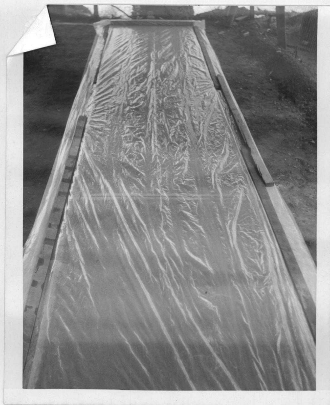
Fig. 3.4.7 - Proteção da argamassa logo após o acabamento, com capa plástica de cor clara para evitar evaporação da água de amassamento.
