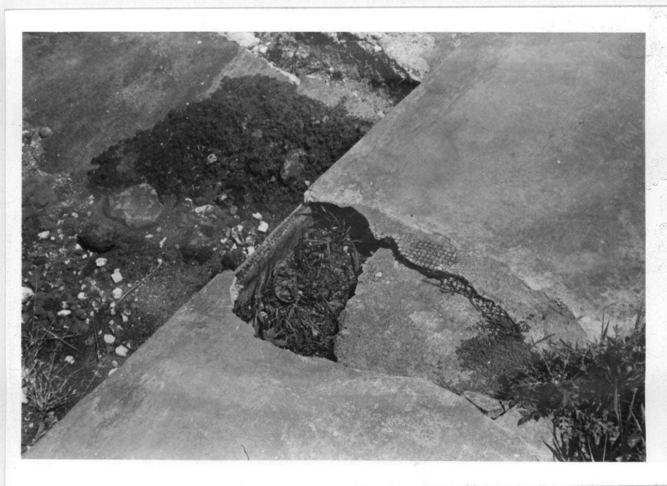
Fig. 3.2.15 - Ruptura e afundamento da "prainha". Note-se o vazio no local.
