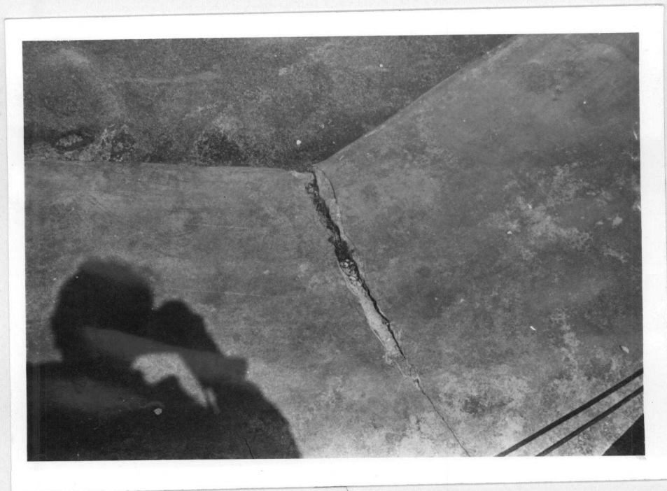
Fig. 3.2.13 - Destruição da argamassa e corrosão das telas na "prainha".
