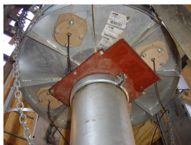
Figura 12 – Detalhes da boca de descarga do silo piloto.
